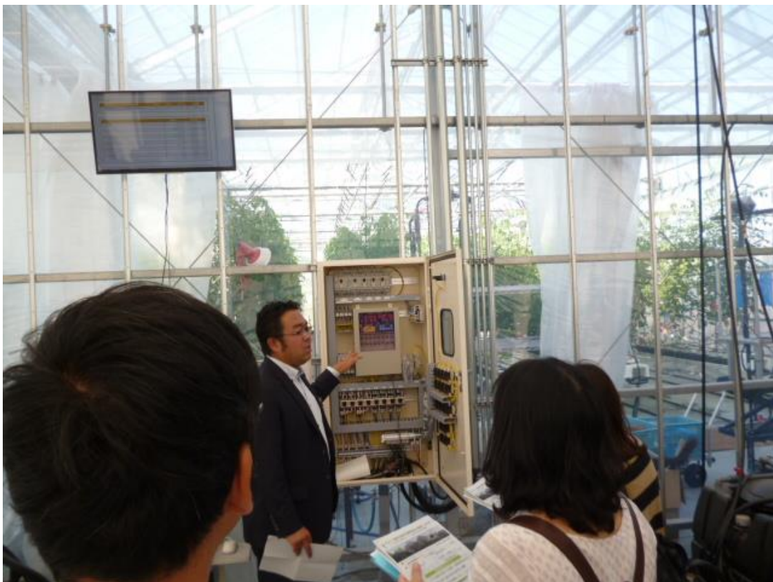
農業研究センター 環境制御ハウス（複合制御盤）
